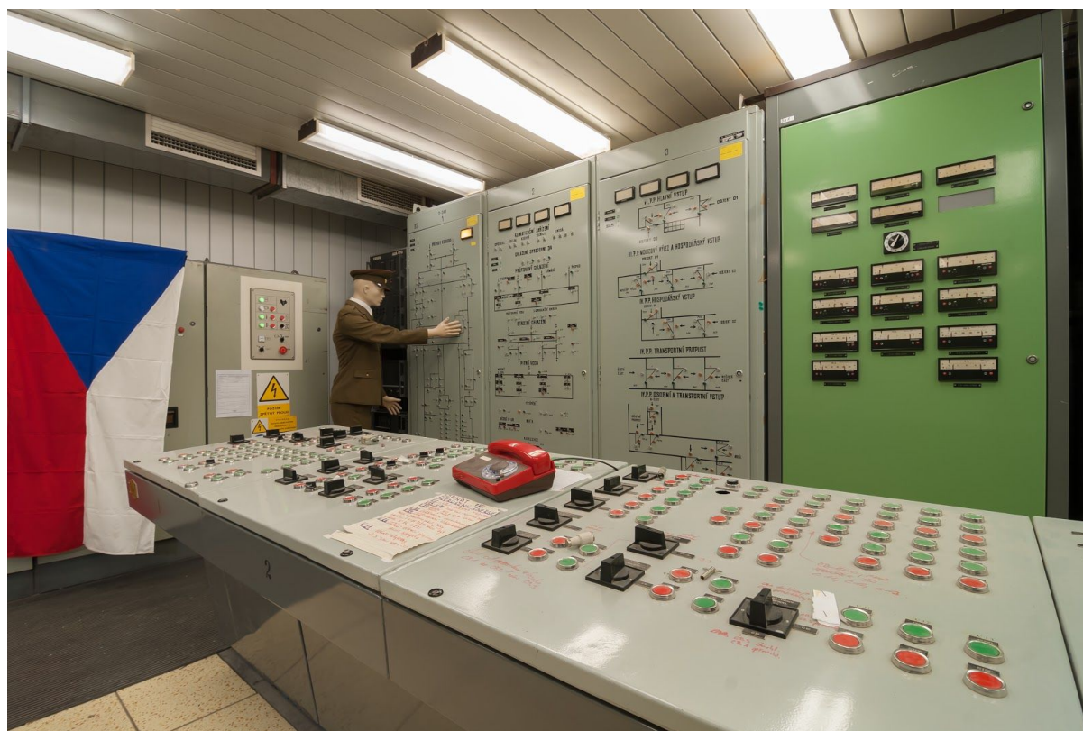
Harmony Bunker Exposition - velín protiatomového krytu
